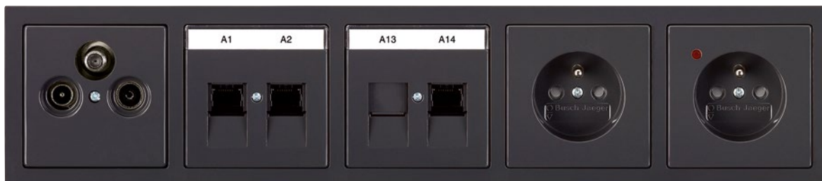
Zásuvka anténa TV+R+SAT; zásuvka komunikačná dvojnásobná, s clonkami; zásuvka komunikačná dvojnásobná, s clonkami; zásuvka jednonásobná s clonkami; zásuvka jednonásobná s clonkami, s ochranou pred prepätím
