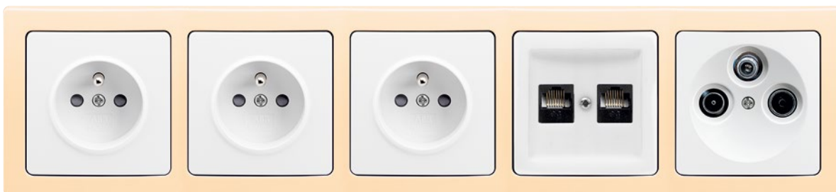
Zásuvka jednonásobná s clonkami; zásuvka jednonásobná s clonkami; zásuvka jednonásobná s clonkami; zásuvka komunikačná dvojnásobná; zásuvka anténa TV+R+SAT
